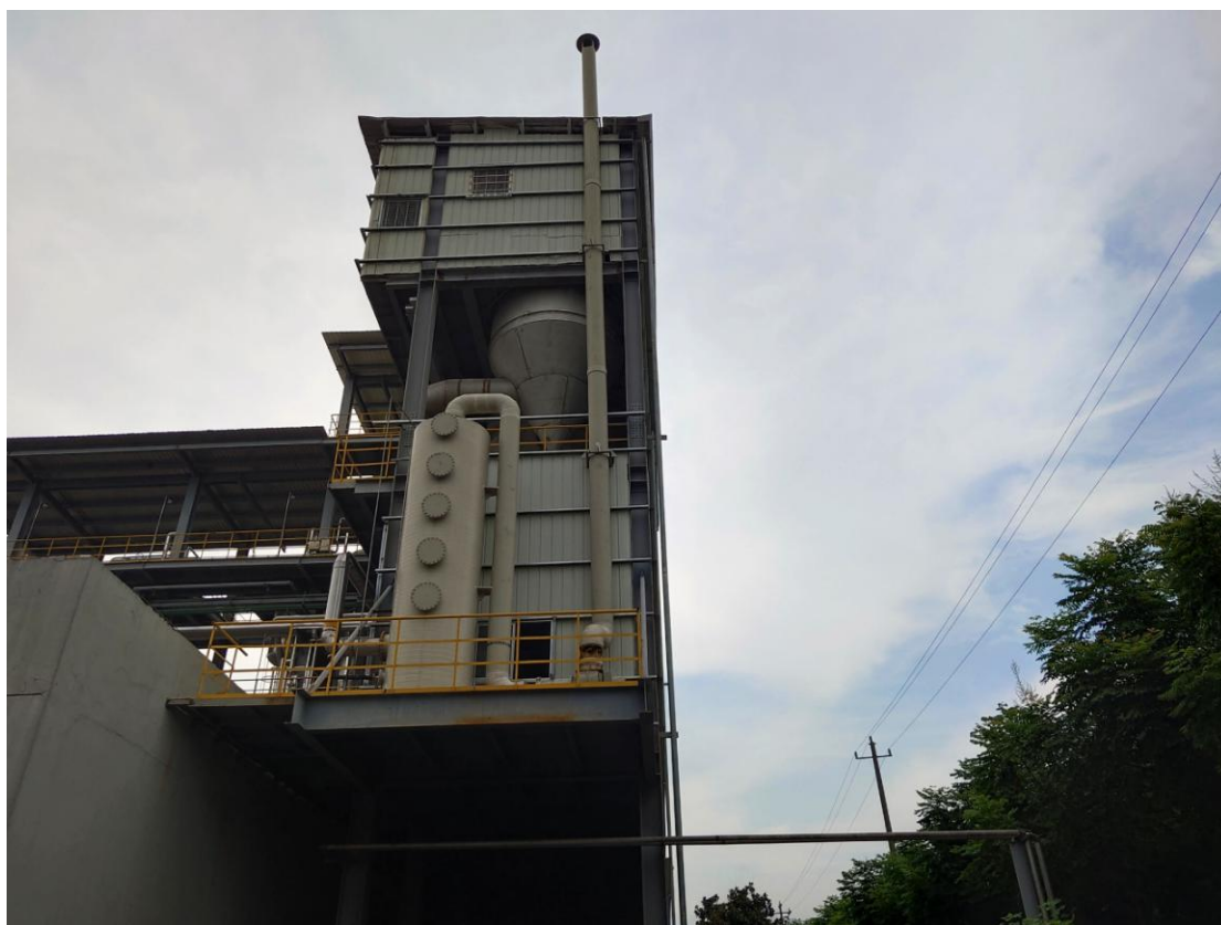
图4-2 本项目蒸馏单甘酯真空泵废气处理设施图
