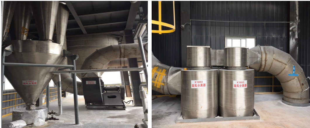
图 4-4 本项目旋风除尘器处理设施图
