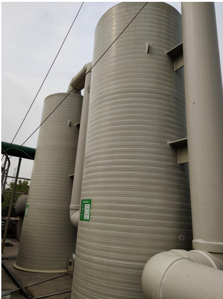
图 4-6 本项目污水处理站废气处理设施图
