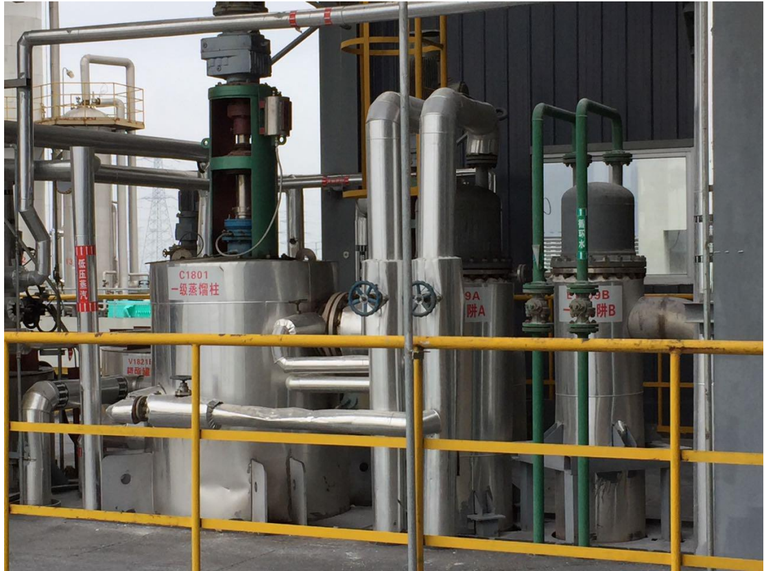
图 4-5 本项目甘油回收处理设施图
