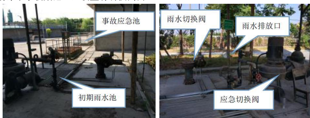
图 4-7 事故应急池、初期雨水池
