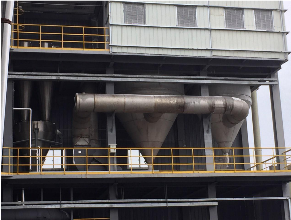
图 4-3 本项目沉降室处理设施图
